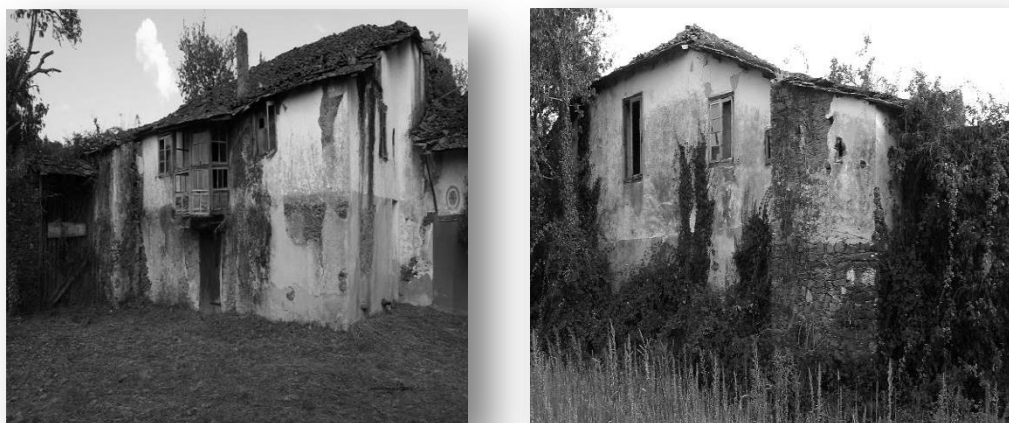
IMAGEN III: Derecha fachada principal casa rectoral de S. Martín de Bascós colindante con iglesia parroquial por lateral derecho y portalón de salida a finca por lateral izquierdo, centro fachada pequeña galería cubierta situada al suroeste y que, lo mismo que la fachada de la iglesia, mira al camino que desemboca en la villa monfortina y bordea ambas edificaciones. Izquierda parte posterior de la casa rodeada de diversos árboles (olivo, higueras,...) y algún parral más finca con pozo. Setiembre 2019
